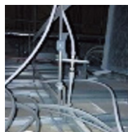
天井裏設置例
