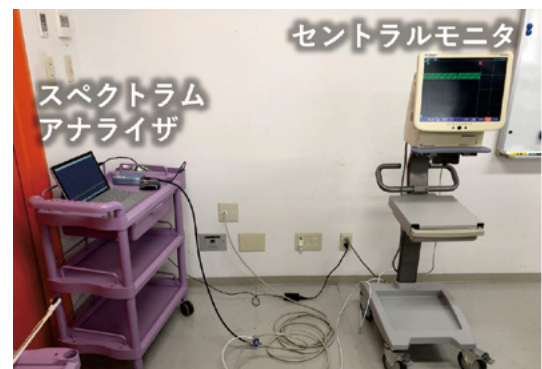
写真-4 受信アンテナ設置後の接続例
